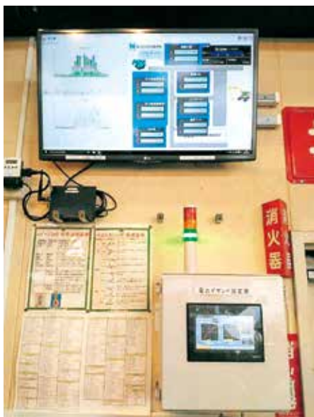
(工場内での稼働状況)
